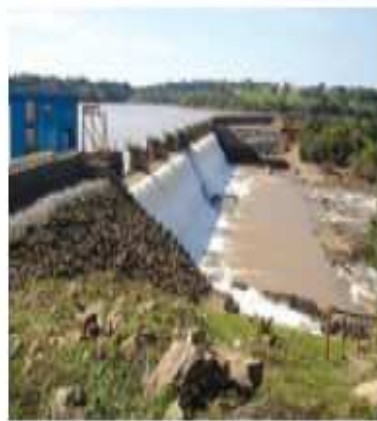
Barragem de Ernestina, em obra de revitalização da estrutura para uma nova vida útil da barragem e ampliação do aproveitamento energético
